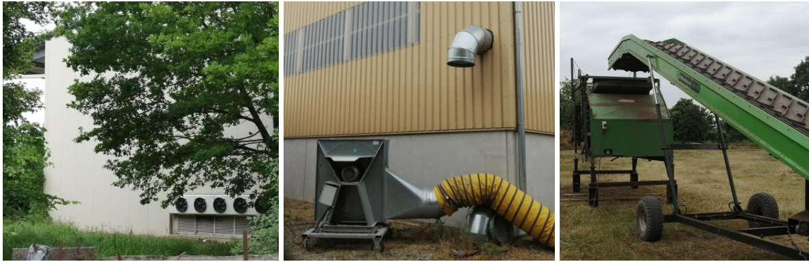
Bild 3: Kühlanlage Kartoffelhalle, mobiles Trocknungsgebläse, Kartoffelreinigung (zukünftig in einer Halle)
