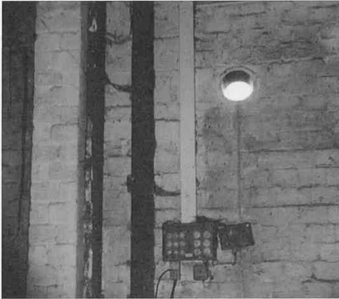
Photo 1: Ein-/Ausflugöffnung im Mauerwerk, Gebäude B
