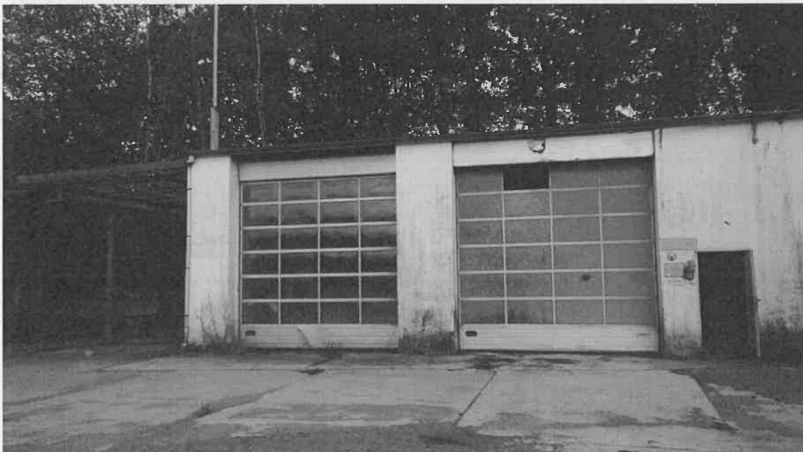
Photo 2: Ein-/Ausflugöffnung durch fehlende Scheibe im Rolltor, Gebäude B.
