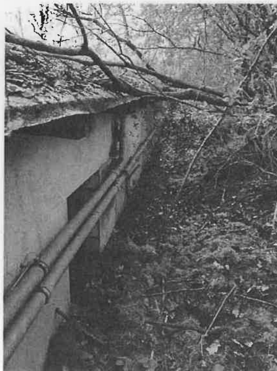
Foto 8 Heizöl-Zuleitungen im Böschungsbereich hinter Halle Produktion/Verladung
