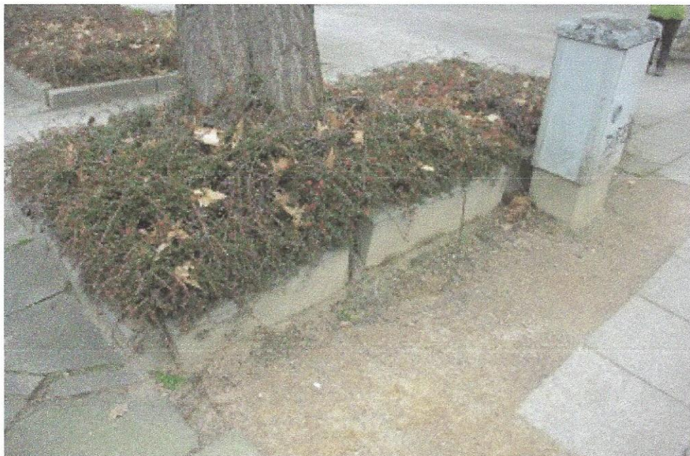
hochgedrückte Tiefborde der Randeinfassung
