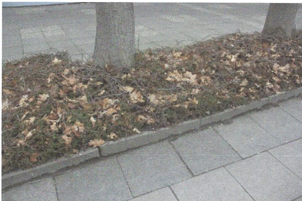
hochgedrückte Randeinfassung der Baumscheibe sowie Plattenbelag
