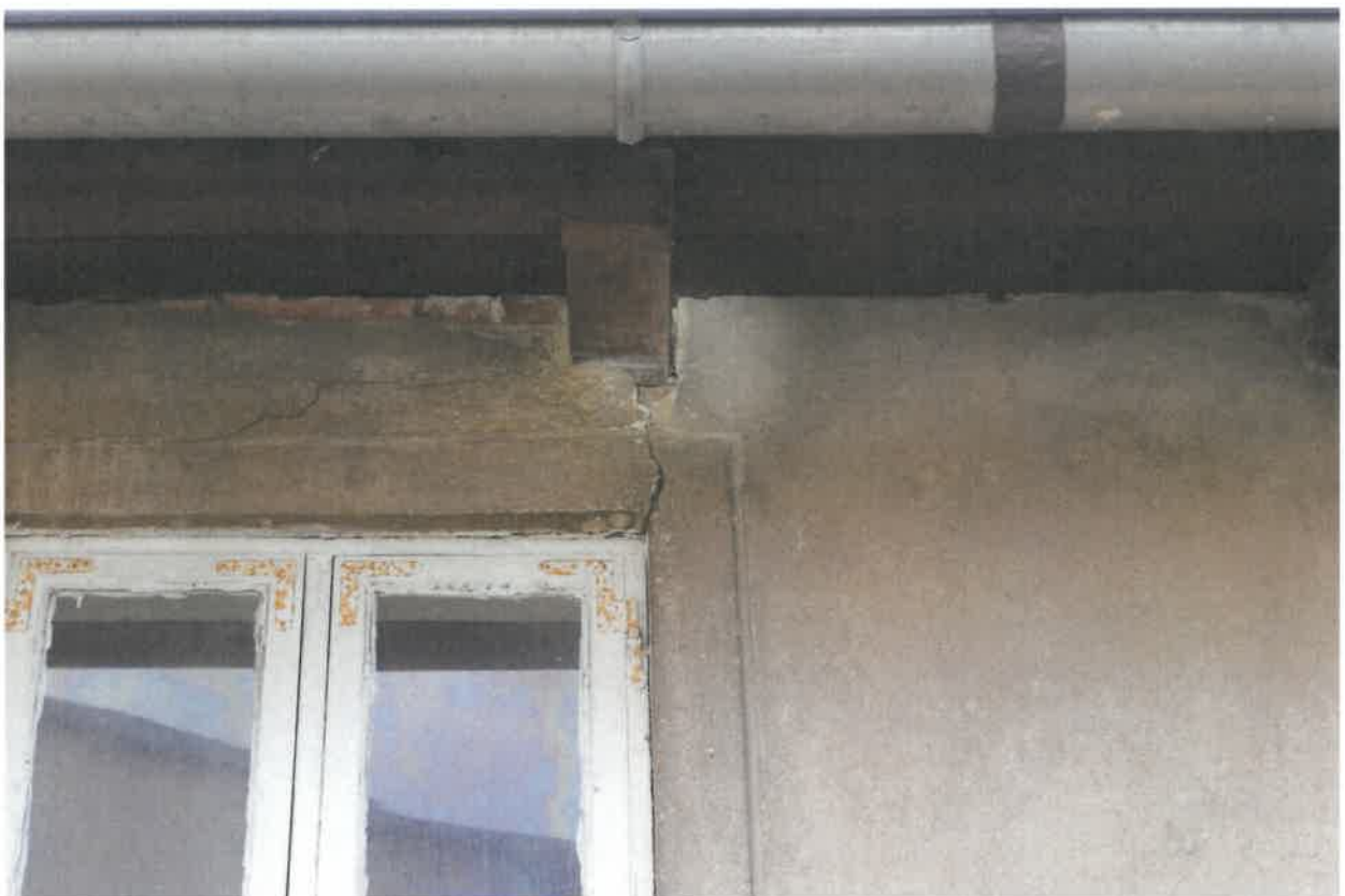
Abbildung 6: Potenzielle Quartiermöglichkeiten unter Dachüberstand.
