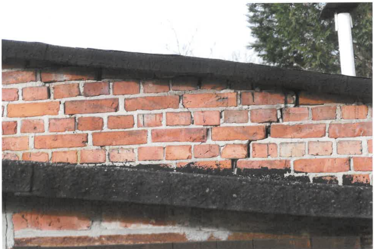
Abbildung 12: Fugen im Mauerwerk an Gebäude 2.
