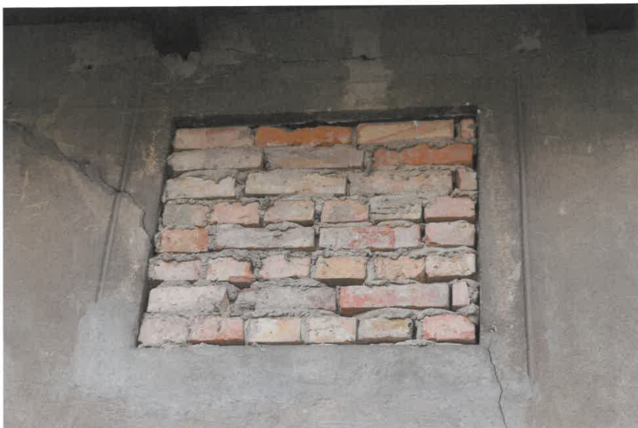
Abbildung 7: Ausgemauertes Fenster mit offenen Fugen.
