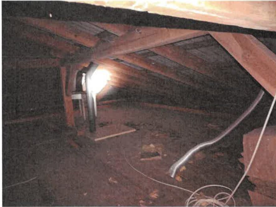
Abbildung 8: Dachboden, schwer einsehbar mit morschem Boden.
