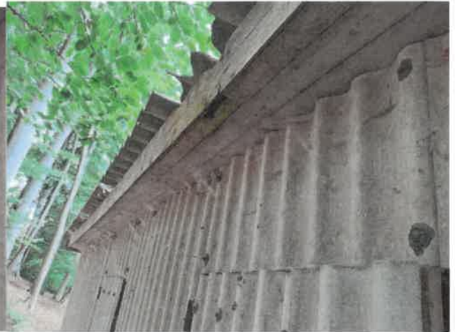
Abbildung 5: potenzielle Einflugstelle für Fledermäuse
