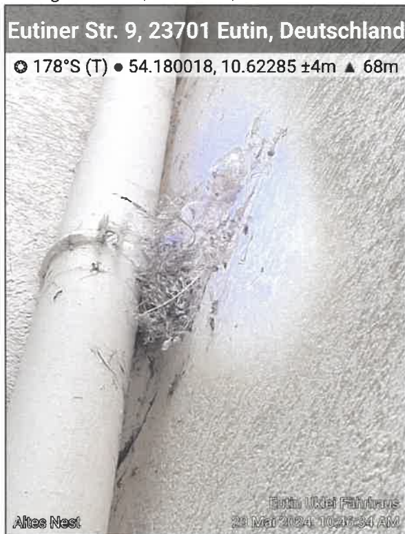
Abbildung 53: Altes Nest hinter Regenrohr, Ostseite Gebäude 2 (Foto: Planungsbüro ALSE, 29.05.2024)
