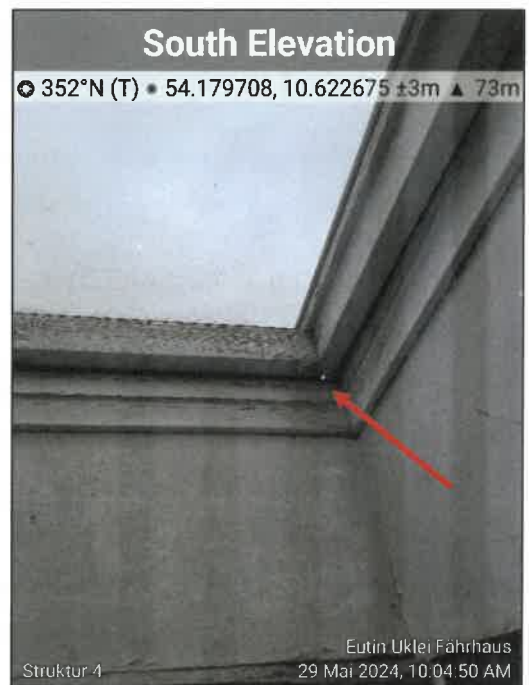
Abbildung 45: Spalt an Dachfenster (Foto: Planungsbüro ALSE, 29.05.2024)
