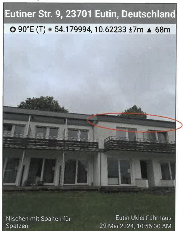
Abbildung 58: Nischen zwischen Dachverkleidung Fassade (Foto: Planungsbüro ALSE, 29.05.2024)
