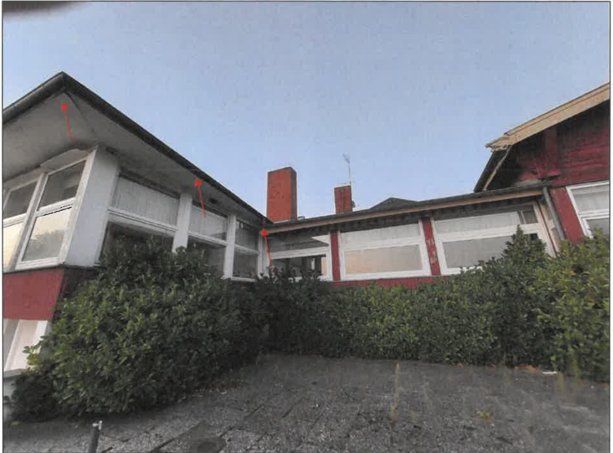
Abbildung 41: Nischen und Spalten an der Westseite von Gebäude Nr. 1 (Foto: ALSE GmbH, 25.08.2024)
