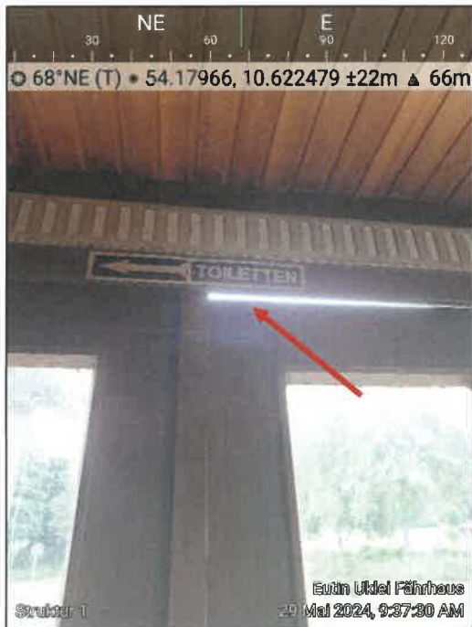
Abbildung 42: Spalt an der Tür zum Restauranteingang, Ostseite von Gebäude 1 (Foto: Planungsbüro ALSE, 29.05.2024)
