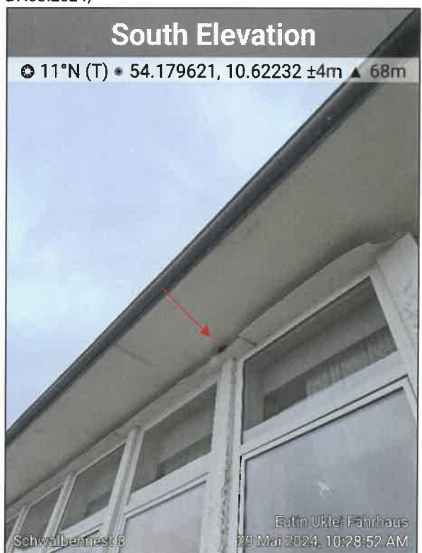
Abbildung 24: Mehlschwalbennest am Dachüberstand Westseite von Gebäude 1 (Foto: Planungsbüro ALSE, 29.05.2024)
