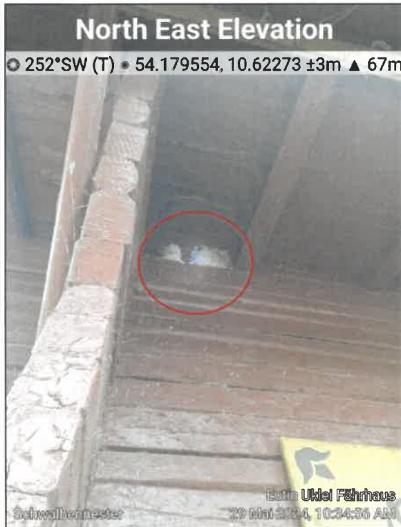
Abbildung 25: Mehlschwalbennest am Dachüberstand Östseite von Gebäude 1 (Foto: Planungsbüro ALSE, 29.05.2024)
