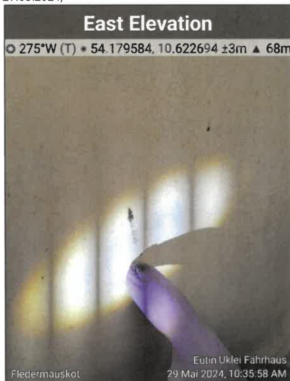
Abbildung 27: Fledermauskot an Fensterlade, Ostseite von Gebäude 1 (Foto: Planungsbüro ALSE, 29.05.2024)
