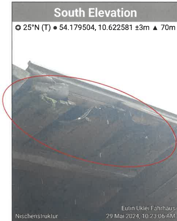
Abbildung 17: Nischenstrukturen am Dachüberstand (Foto: Planungsbüro ALSE, 29.05.2024)
