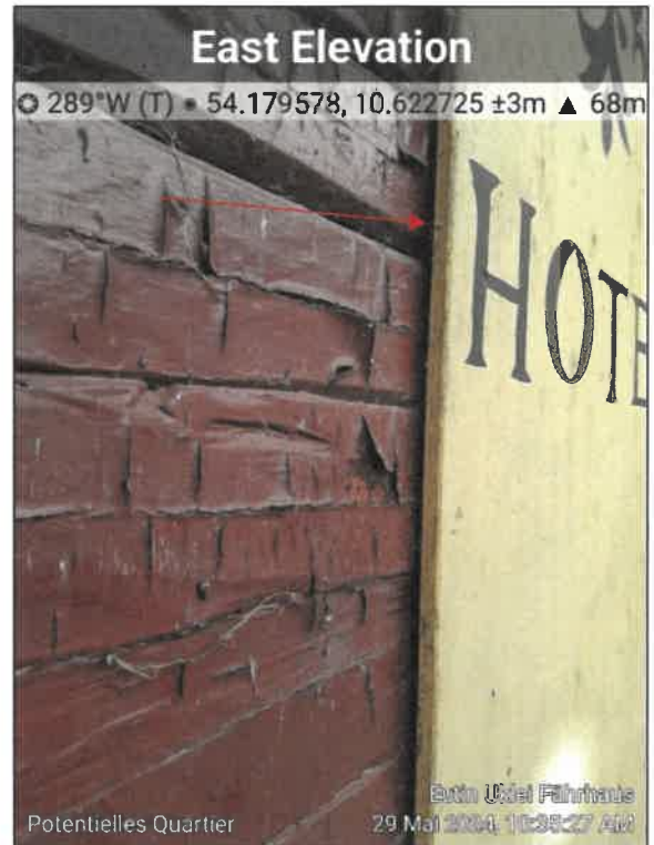
Abbildung 26: Durch Kotspuren nachgewiesenes Quartier für Fledermäuse, Ostseite von Gebäude 1 (Foto: Planungsbüro ALSE, 29.05.2024)
