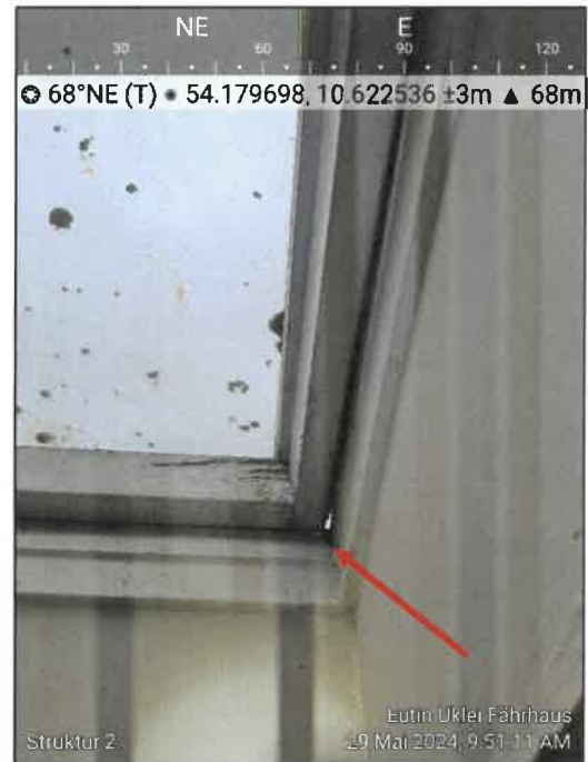
Abbildung 43: Spalt am Dachfenster durch defekten Rahmen (Foto: Planungsbüro ALSE, 29.05.2024)
