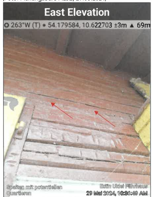
Abbildung 28: Spalt zwischen den Holz balken der Ostfassade von Gebäude 1 (Foto: Planungsbüro ALSE, 29.05.2024)
