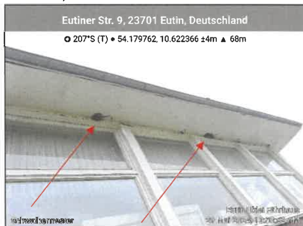
Abbildung 35: Mehlschwalbennest am Dachüberstand an der Nordseite von Gebäude 1 (Foto: Planungsbüro ALSE, 29.05.2024)
