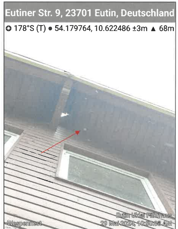
Abbildung 34: Wespennest am Dachüberstand, Nordseite von Gebäude 1 (Foto: Planungsbüro ALSE, 29.05.2024)
