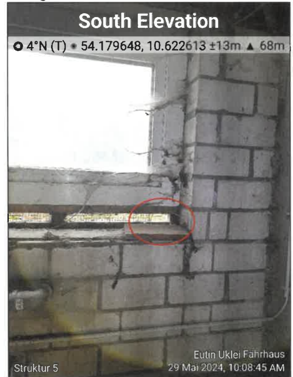
Abbildung 49: Loch im Lüftungsnetz am Kellerfenster, Nordseite von Gebäude 1 (Foto: Planungsbüro ALSE, 29.05.2024)
