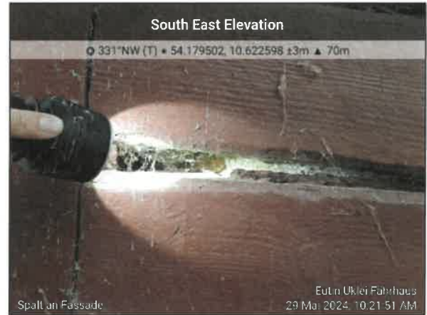
Abbildung 14: Spalt zwischen den Holzbalken der Südfassade (Foto: Planungsbüro ALSE, 29.05.2024)
