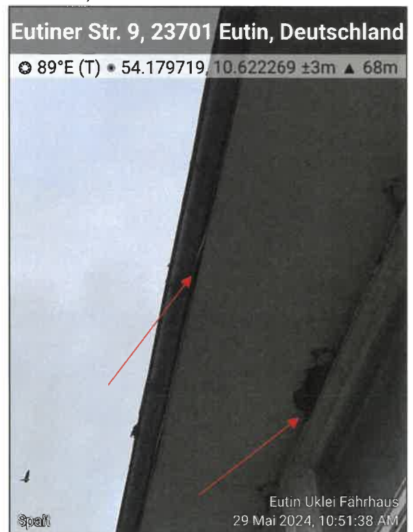
Abbildung 36: Spalt hinter der Regenrinne und Mehlschwalbennest an der Nordseite von Gebäude 1 (Foto: Planungsbüro ALSE, 29.05.2024)
