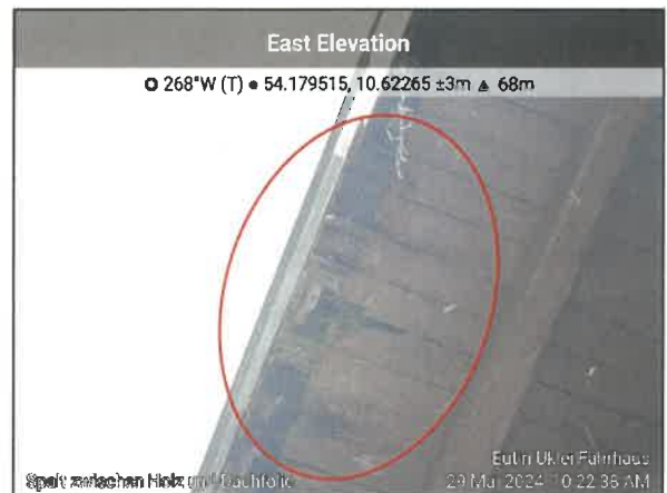
Abbildung 16: Nischenstrukturen am Dachüberstand (Foto: Planungsbüro ALSE, 29.05.2024)
