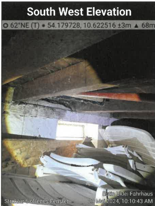
Abbildung 50: Geöffnetes Kellerfenster (Foto: Planungsbüro ALSE, 29.05.2024)
