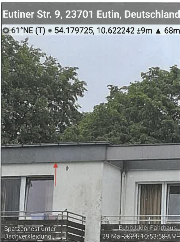
Abbildung 57: Sperlingsnest unter Dachverkleidung, Westseite Gebäude 2 (Foto: Planungsbüro ALSE, 29.05.2024)
