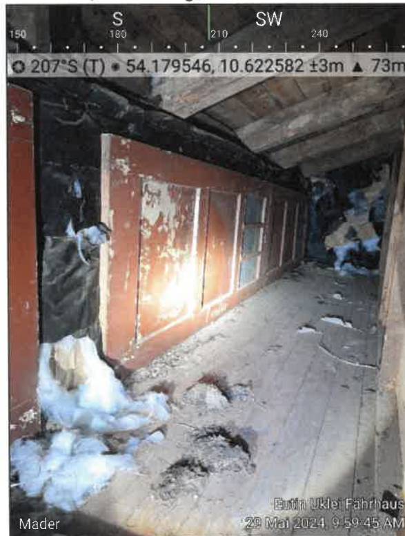
Abbildung 48: Spuren von Marderaktivitäten im Dachstuhl (Foto: Planungsbüro ALSE, 29.05.2024)
