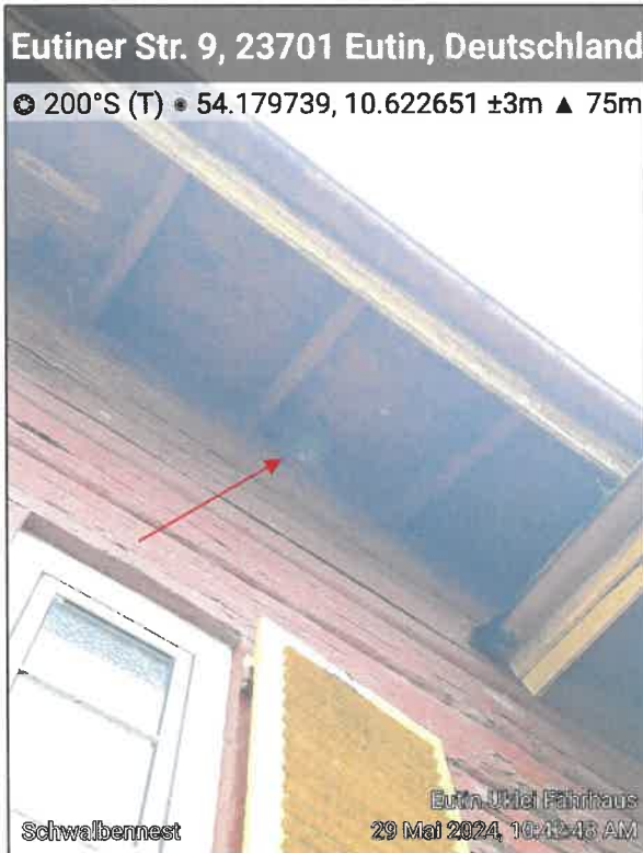
Abbildung 33: Mehlschwalbennest am Dachüberstand, Ostseite von Gebäude 1 (Foto: Planungsbüro ALSE, 29.05.2024)
