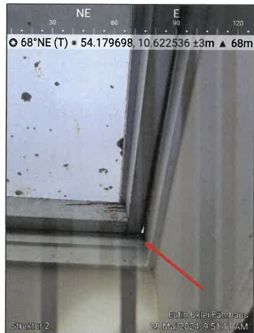
Abbildung 43: Spalt am Dachfenster durch defektem Rahmen (Foto: Planungsbüro ALSE, 29.05.2024)
