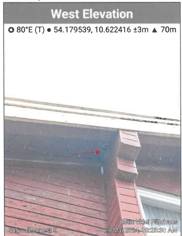
Abbildung 20: Mehlschwalbennester am Dachüberstand Südseite von Gebäude 1 (Foto: Planungsbüro ALSE, 29.05.2024)
