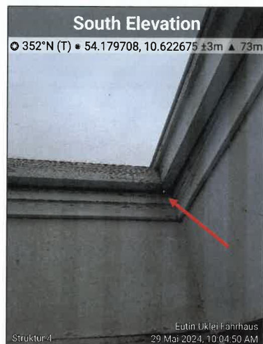
Abbildung 45: Spalt an Dachfenster (Foto: Planungsbüro ALSE, 29.05.2024)
