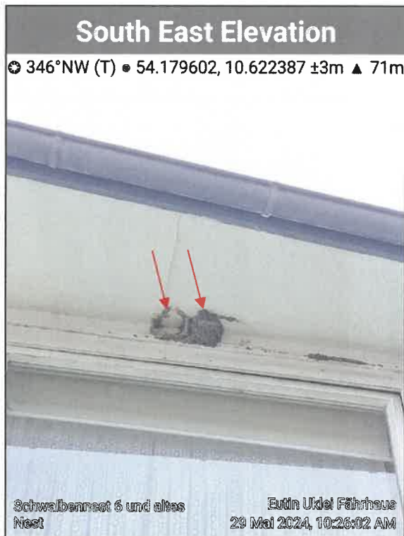
Abbildung 21: Mehlschwalbennester (das li. beschädigt, evtl. aus dem Vorjahr) am Dachüberstand, Westseite von Gebäude 1 (Foto: Planungsbüro ALSE, 29.05.2024)
