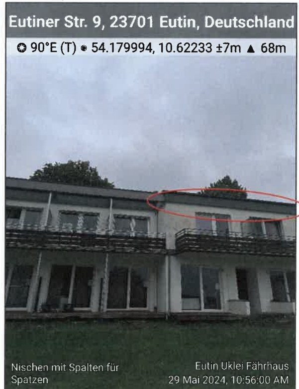
Abbildung 58: Nischen zwischen Dachverkleidung Fassade (Foto: Planungsbüro ALSE, 29.05.2024)
