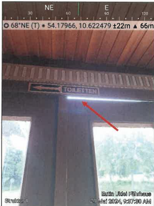
Abbildung 42: Spalt an der Tür zum Resturanteingang, Ostseite von Gebäude 1 (Foto: Planungsbüro ALSE, 29.05.2024)
