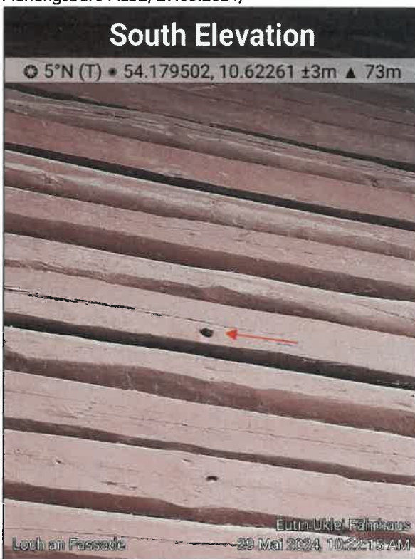
Abbildung 15: Loch in der Holz fassade auf der Südseite (Foto: Planungsbüro ALSE, 29.05.2024)
