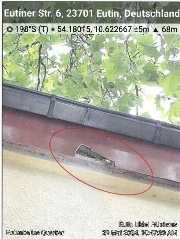
Abbildung 55: Loch in der Verkleidung, Nordseite Gebäude 2 (Foto: Planungsbüro ALSE, 29.05.2024)
