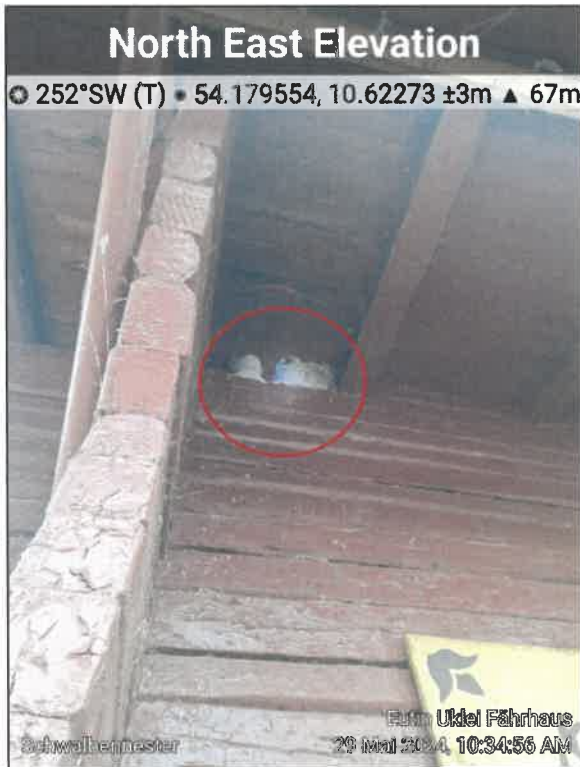
Abbildung 25: Mehlschwalbennest am Dachüberstand Ostseite von Gebäude 1 (Foto: Planungsbüro ALSE, 29.05.2024)
